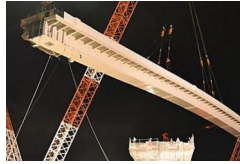
国内最大級クレーンがJR線の上へ一夜で渡線橋架ける 北九州市
